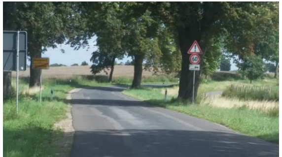
Die Kreisstraße zwischen Grambow und Wittenförden muss dringend saniert werden.
